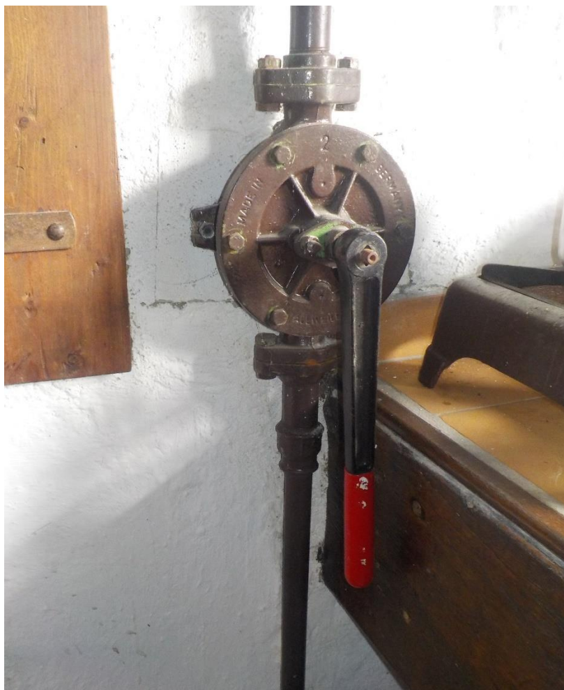
Ancienne pompe à eau de la cuisine.
